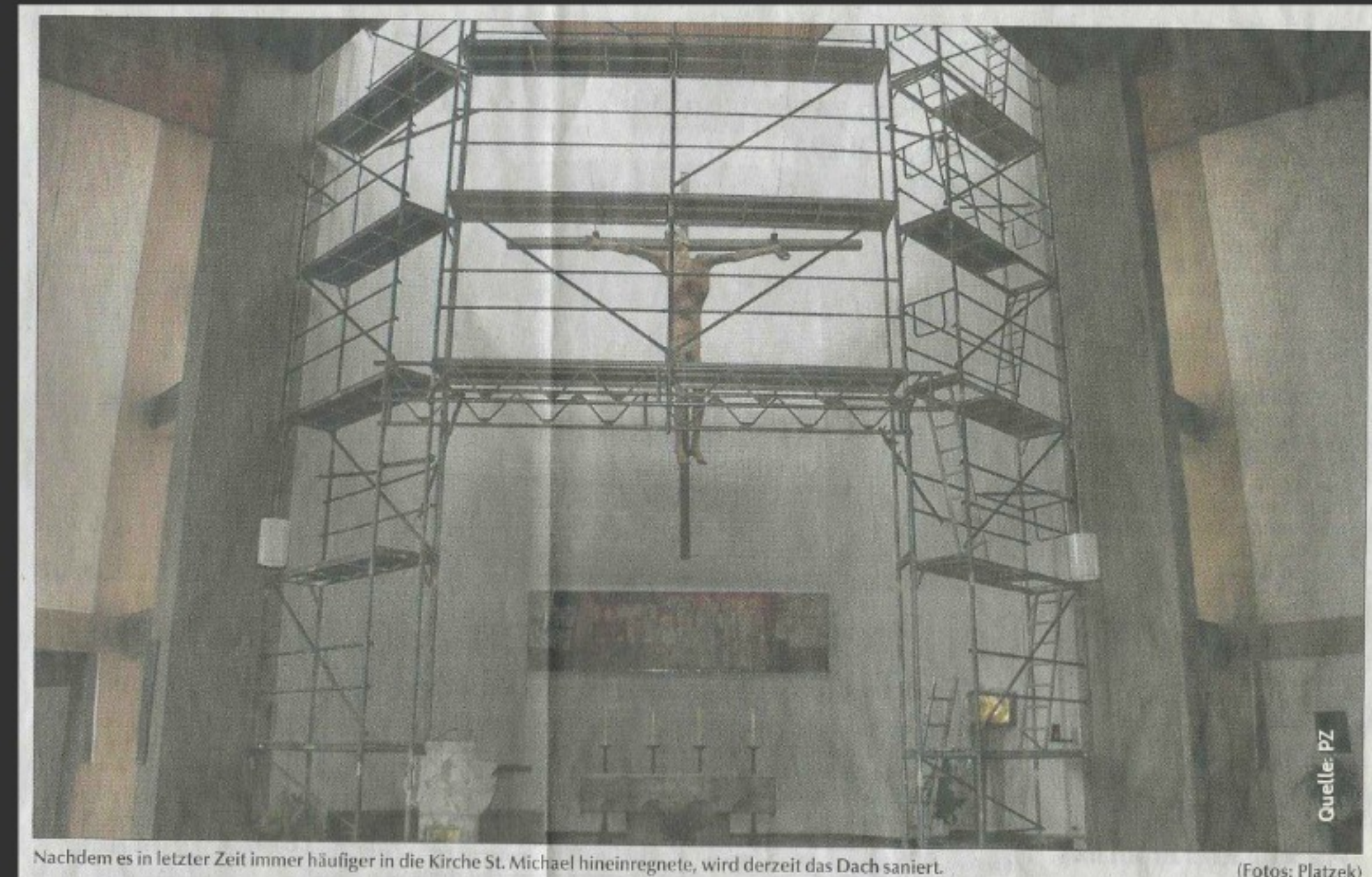
Nachdem es in letzter Zeit immer häufiger in die Kirche St. Michael hineinregnete, wird derzeit das Dach saniert.
